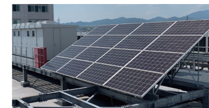
本社屋上設置の太陽光パネル
